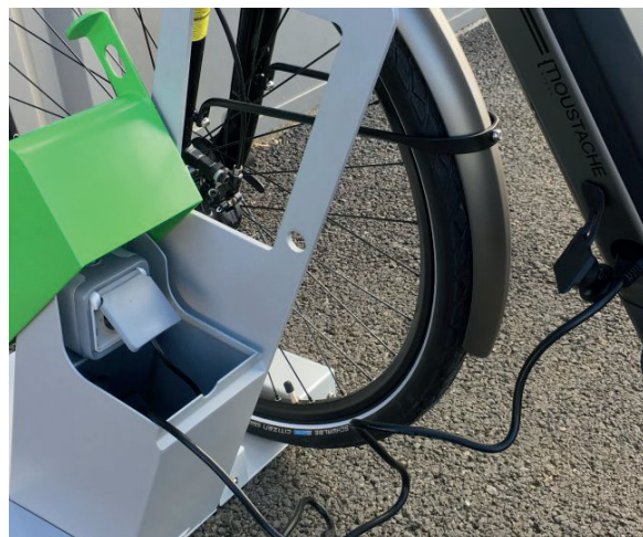
Exemple de borne de recharge électrique
